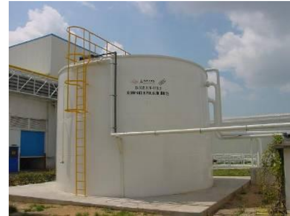
Kimyasal arıtma tesisi
